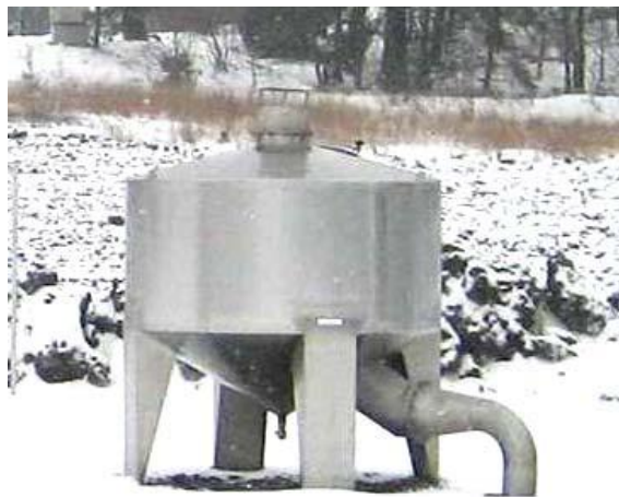
Figur 5 Aktiv kolfilter vid Norrköping biogasanläggning
