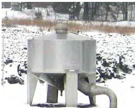
Figur 5 Aktiv kolfilter vid Norrköping biogasanläggning
